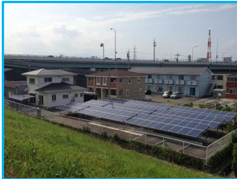
太陽光パネル
